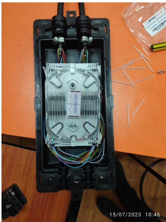
Anexo 30. Terminal (Manga de 144 Hilos) fusionado y listo para su uso
