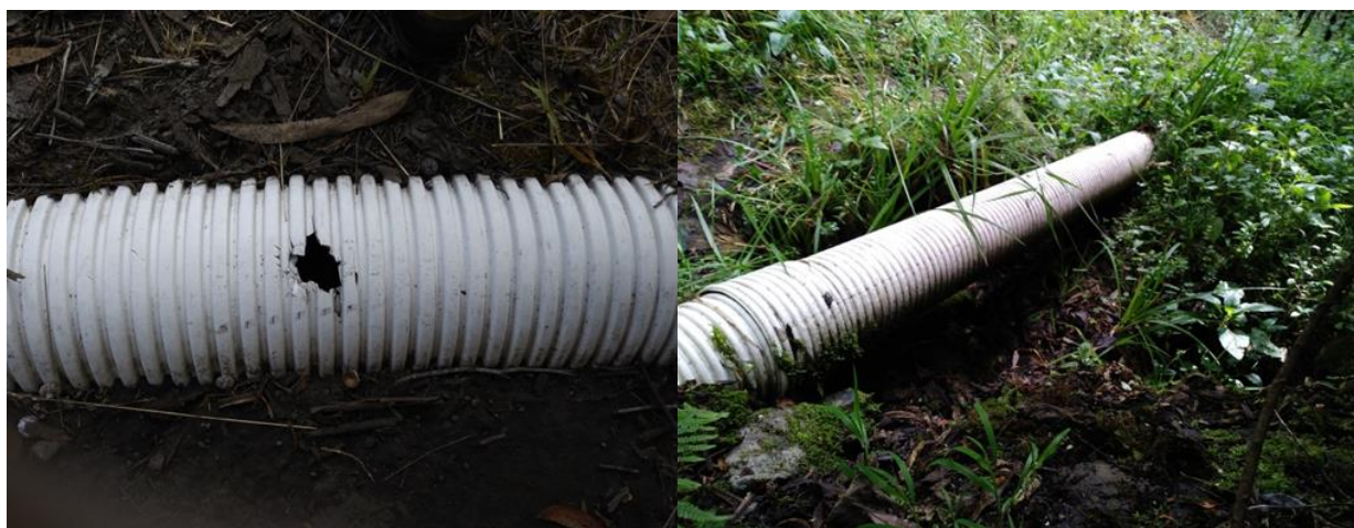
Figura 43: a. Tubería rota.
