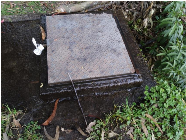
Figura 45: Agua que sobrepasa la capacidad de la cámara rompe presión.
