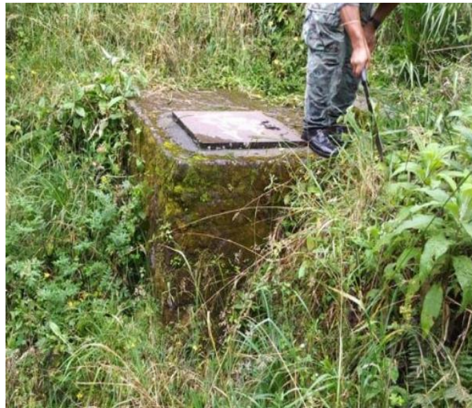
Figura 38: Cámara rompe presión.
