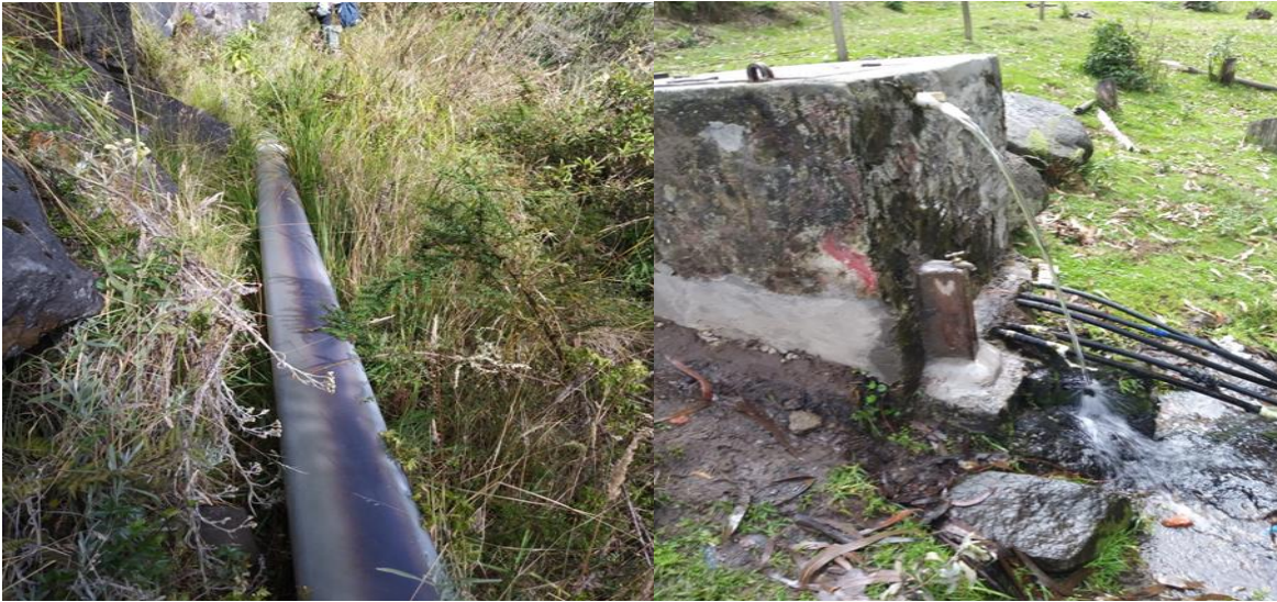
Figura 44: a. Tubería en zona de riesgo por movimiento de masas. b. Agua que se pierde constantemente.
