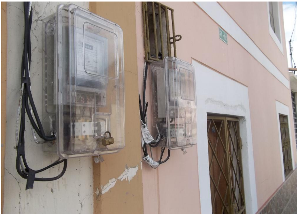
Fotografía N°23: Servicios de electricidad en la parroquia Andrade Marín © Autor Pablo Sebastián Chiriboga Villacreces
