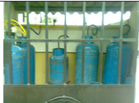
Fotografía N.8, Central de Gas ITHI
